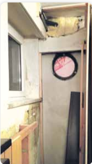
Wasserschaden: Die Wurzel des Übels.
